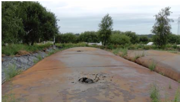
Abbildung 5.1-3 Zustand der Entwässerungsschläuche ca. 2 Monate nach Beendigung der Befüllung [MATTHÄI]
