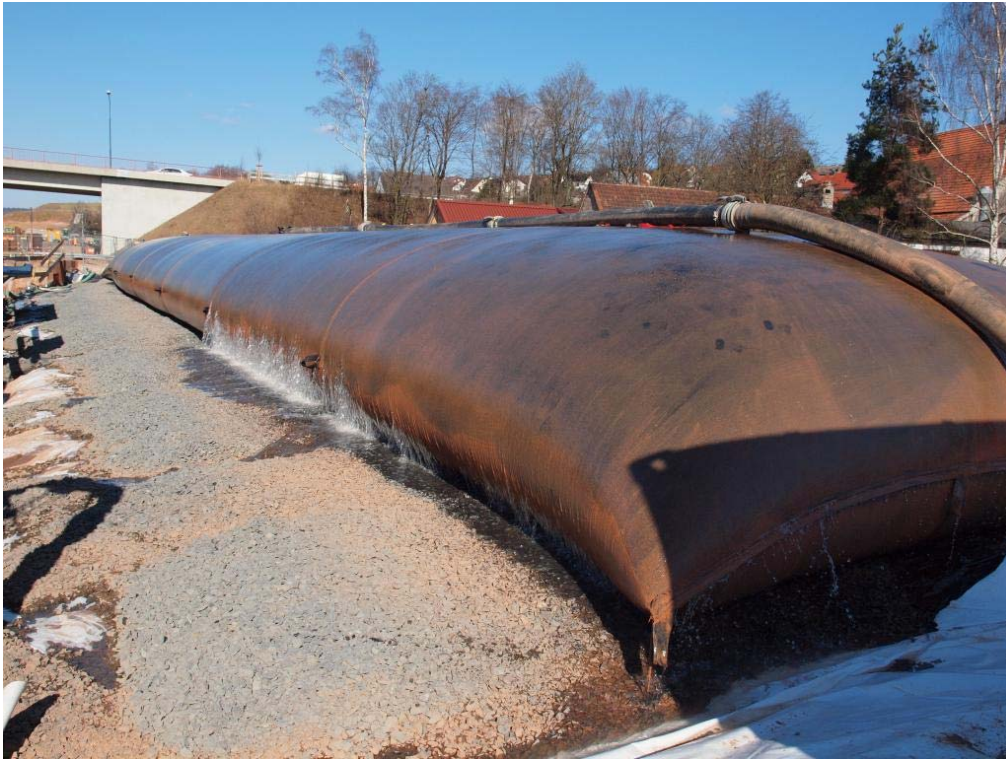
Abb. 3.2 Entwässerungsschlauch auf dem Entwässerungsfeld im Betrieb
