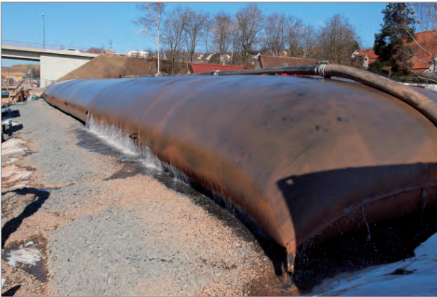
SoilTain®-Entwässerungsschlauch im Betrieb
