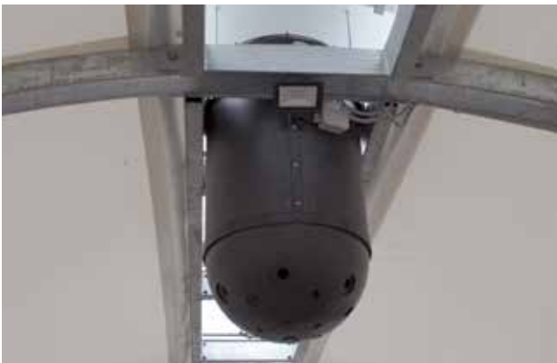
Permanente zentrale Belüftung mit integriertem Temperatursensor
