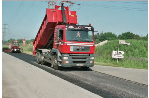
Die Asphaltbewehrung kann bei Bedarf nach fachgerechten Verlegen mit Edelsplitt 2/5 mm ca. 1,0 m 2 abgestreut werden.
