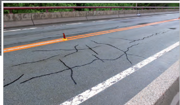
Deutliche Rissbildungen in der Fahrbahndecke vor der Sanierung.
