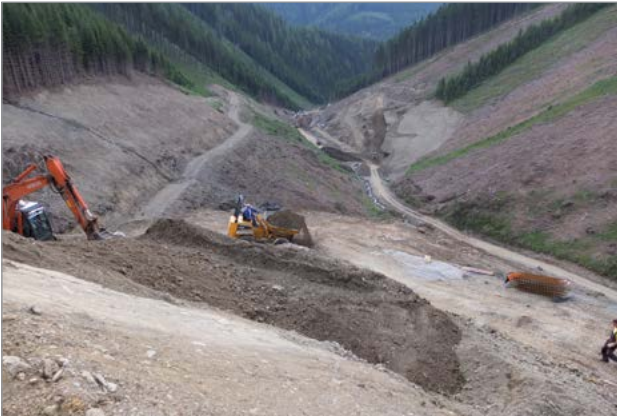
Vorbereitungsarbeiten für die Dammaufstandsflächen der kunststoffbewehrten Steilböschungen an der westlichen Talflanke des Longsgrabens
