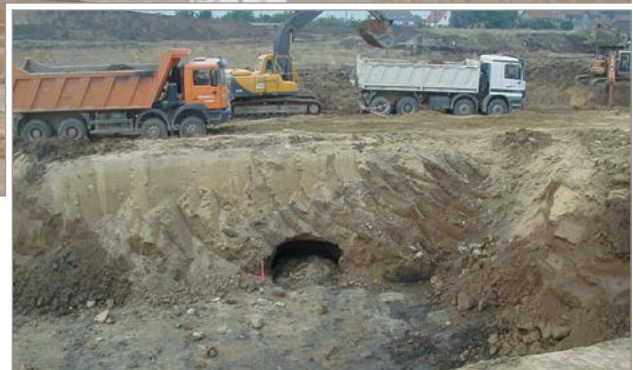
Freigelegter Erdfall während der Bauzeit
