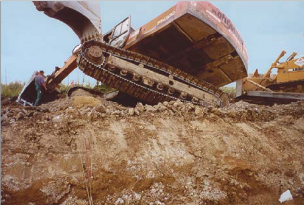
Folge eines aufgetretenen Erdfalls
