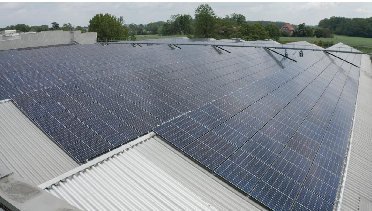
Bild 2: Nahaufnahme der Photovoltaikanlage auf dem Produktionsgebäude in Gescher
