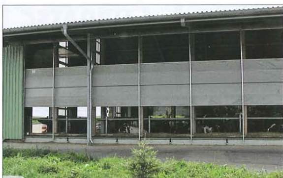
Фото 3: Приток воздуха как в области кровли, так и через лежанки. Благодаря затенению предотвращается перегревание коровника.
