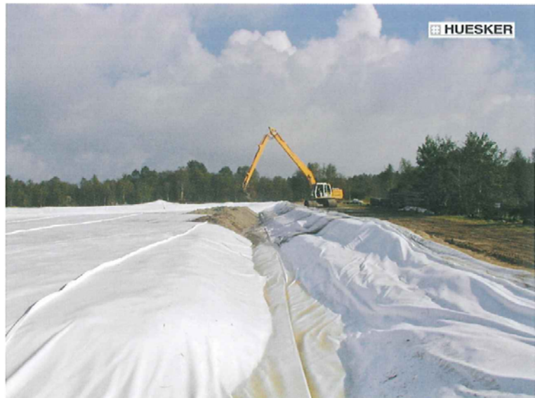
Dank der guten Vorplanung konnte das Großpanel zügig und störungsfrei in das vorbereitete Becken der Deponie verlegt werden.
