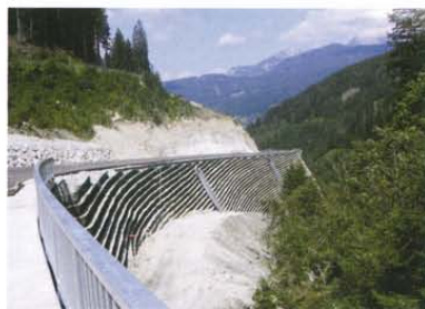
Die bis zu 28 m hohe KBE Konstruktion verhindert das Abrutschen des Hanges.
