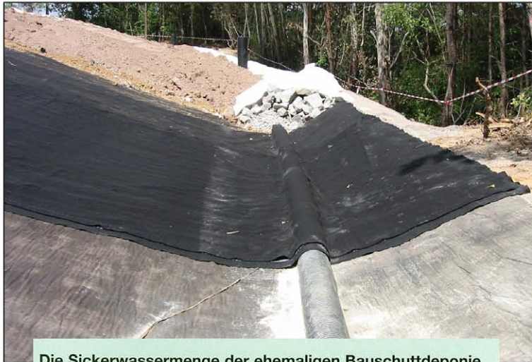
Die Sickerwassermenge der ehemaligen Bauschuttdeponie Goppoltsried sank nach der Rekultivierung mit der doppellagigen „GTD NaBento“ und der Drainagematte „Enkadrain“ deutlich. Abbildungen: Ingenieurgesellschaft Coplan AG
