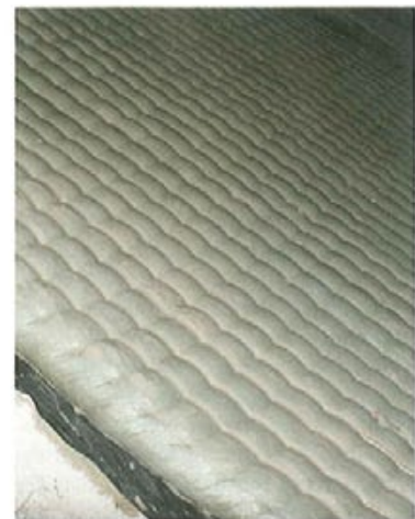
Bild 6: Kissenstruktur der prall gefüllten Auskleidung
