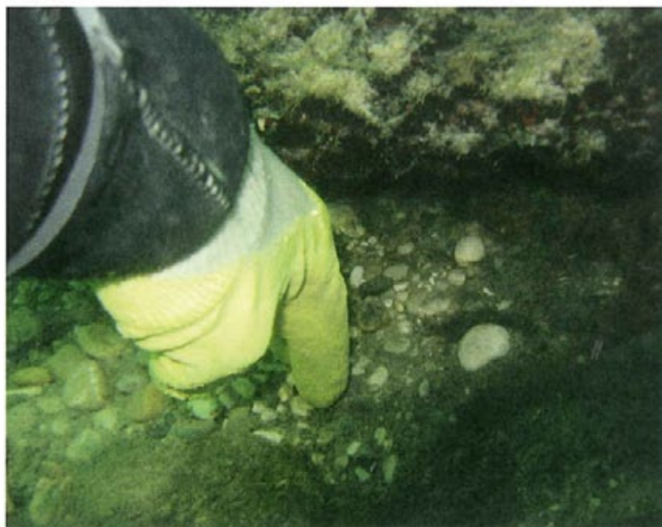
Bild 3: Urzustand: Kantenabbruch der Kanalauskleidung unter Wasser
