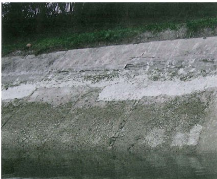
Bild 2: Urzustand: verwitterte Oberfläche der Kanalauskleidung
