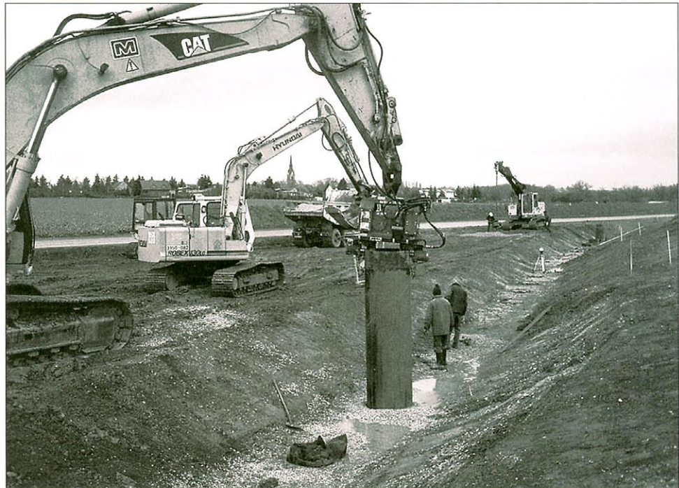
Einbau der Kiesdrainagepfähle, die mit filterstabilen Geokunststoffschläuchen umhüllt sind. Foto und Grafik: Huesker
