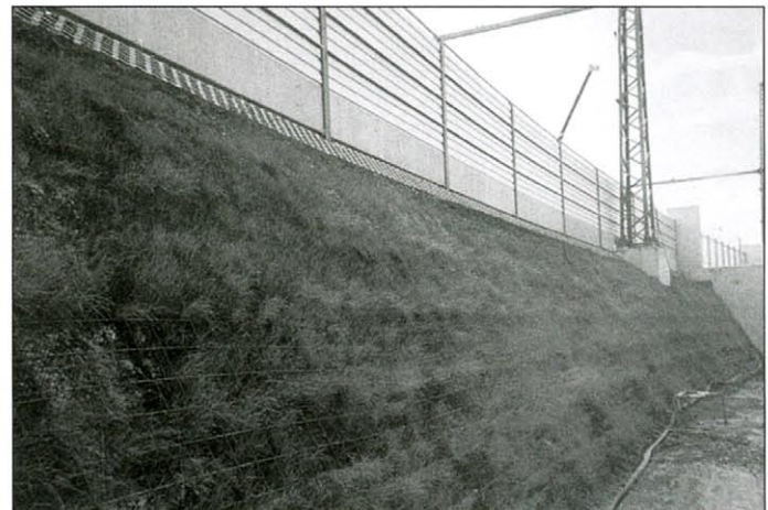
Abbildung 6: Kombinierte Lärmschutzmaßnahmen mit aufgesetzter Lärmschutzwand auf bewehrtem Wall an einer Eisenbahnstrecke
