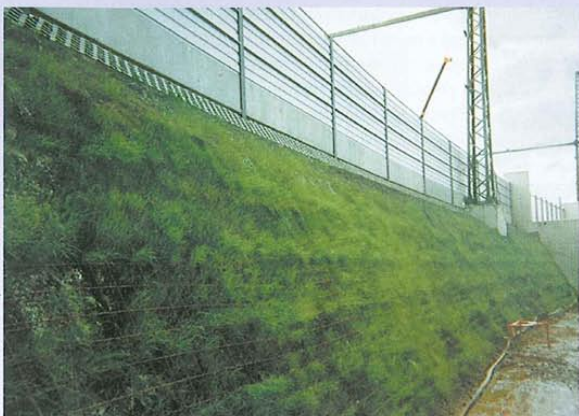
Bild 6: Kombinierte Lärmschutzmaßnahme: aufgesetzte Lärmschutzwand auf bewehrten Wall an einer Eisenbahnstrecke
