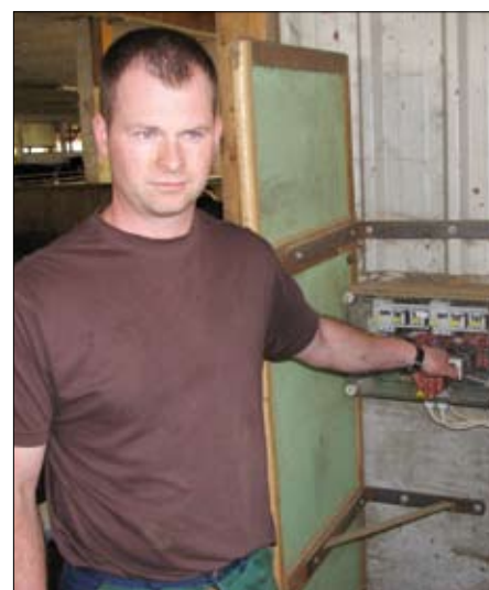
Anlagenleiter Carsten Pöhl kann von dieser Steuerung aus die oben und unten öffnende Wickellüftung auf beiden Stalllängsseiten separat in jede beliebige Stellung fahren.
