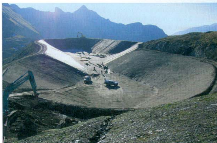
Speicherteich Zehnerkar (Obertauern, A): GU: Plantrans GmbH Obertauern, Abdichtung: Florian Bautechnik GmbH Spittal/Drau, HUESKER Geokunststoffe.
