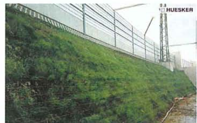
Kombinierte Lärmschutzmaßnahme – aufgesetzte Lärmschutzwand auf bewehrtem Wall an einer Eisenbahnstrecke
