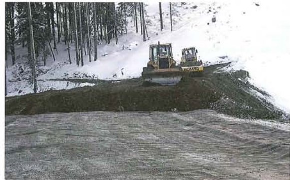
Bild 3. Auch unter extremen Bedingungen (Gelände, Witterung ...) kann Fortrac® eingebaut werden (Fotos: HUESKER synthetic)
