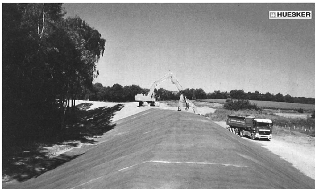
Schutz vor dem Wasser: Am Rotbach in Dinslaken sorgt die Geokunststoff-Ton-Dichtungsbahn (Typ NaBento® RL-N) aus dem Hause HUESKER dafür, dass das Hinterland nicht überflutet werden kann. 15.000 Quadratmeter Dichtungsbahn kapseln die Waschberge ein und verhindern ein Durchfeuchten selbst bei Hochwasser.
