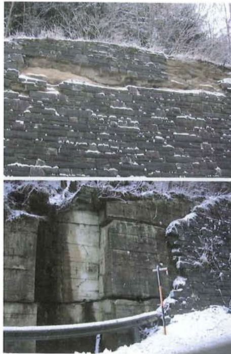
Bild 2. Schäden an Stützwänden der existierenden „alten“ Trasse.
