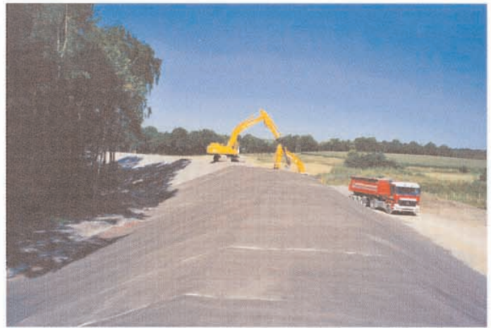
Bild 4. Am Rotbach in Dinslaken sorgt die Geokunststoff-Ton-Dichtungsbahn NaBento RL-N dafür, daß das Hinterland nicht überflutet werden kann
