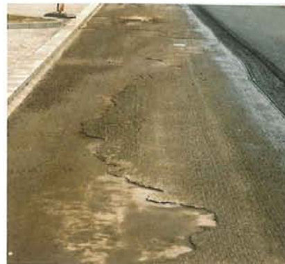
Bild 1. Rissige Binder- und Tragschicht vor der Sanierung
