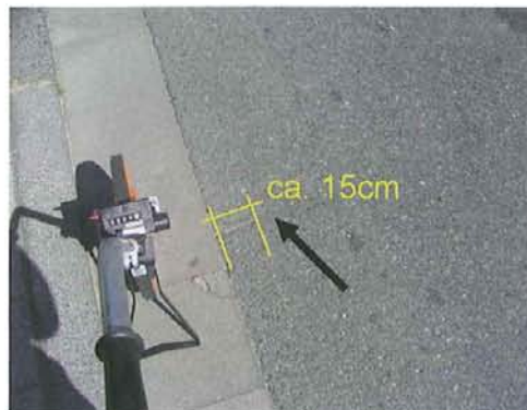
Bild 2. Querriss im Randbereich
