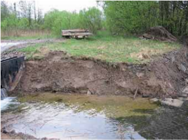
Erosionsprobleme an einem Auslassbauwerk (1)
