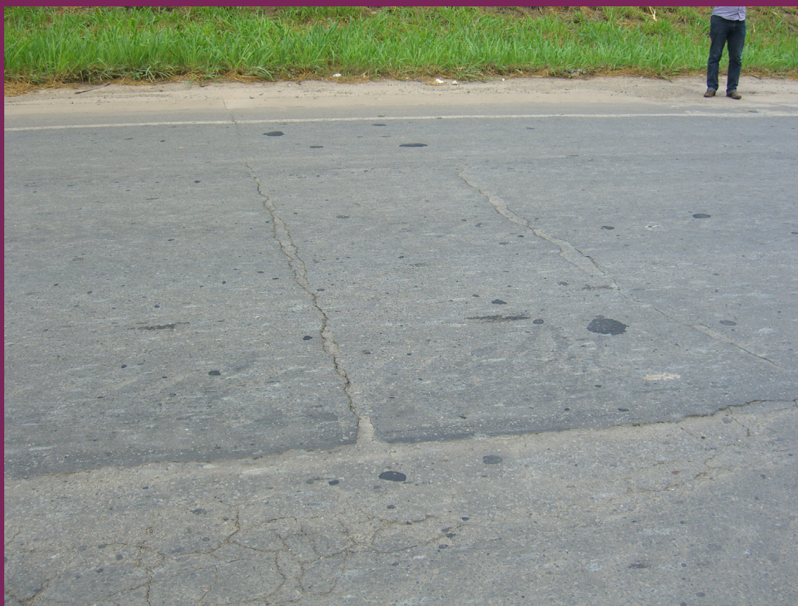
Figura 2 – Vista do pavimento da MG-424 antes da restauração.
