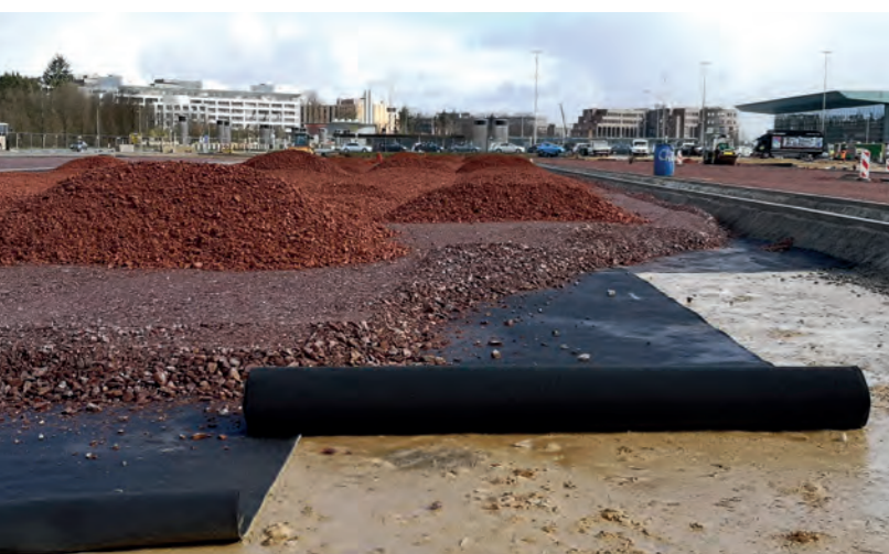
Schadstofffilter unter Parkplatz Luxemburg | Unterhalb der Schotterschicht für einen Parkplatz wurde Tektoseal Active AS verlegt, um Schadstoffe am Eintrag in den Untergrund zu hindern. Tektoseal Active AS lässt Wasser passieren und nimmt nachweislich Öle und Treibstoffe sowie an Partikel haftende Schadstoffe wie Metalle zuverlässig auf. Dies ermöglicht die sichere Gestaltung von wasser-durchlässigen Verkehrsflächen.
