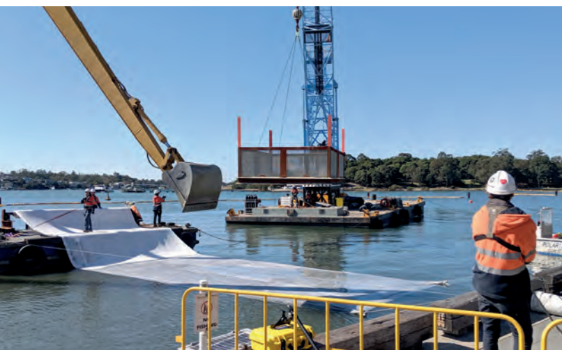
Sicherung belasteter Sedimente Australien | Sicherung von Sedimenten mit hoher PAK- und MKW-Belastung in einer Bucht in Sydney. Einbau von rd. 5.000 m 2 Tektoseal Active AC als Schadstoffsperrschicht zur Verbesserung der Gewässerqualität.
