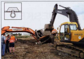
Progetto: treno alta velocità a Groebers (D) - Problematica: presenza di cavità diffuse - Materiale: geogriglia Fortrac® in aramide 1.200 kN/m
