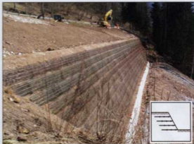
Progetto: Casate (BL) - Problematica: Ripristino di una frana Materiali: geogriglie Fortrac® 35, 55, 80, 110 kN/m
